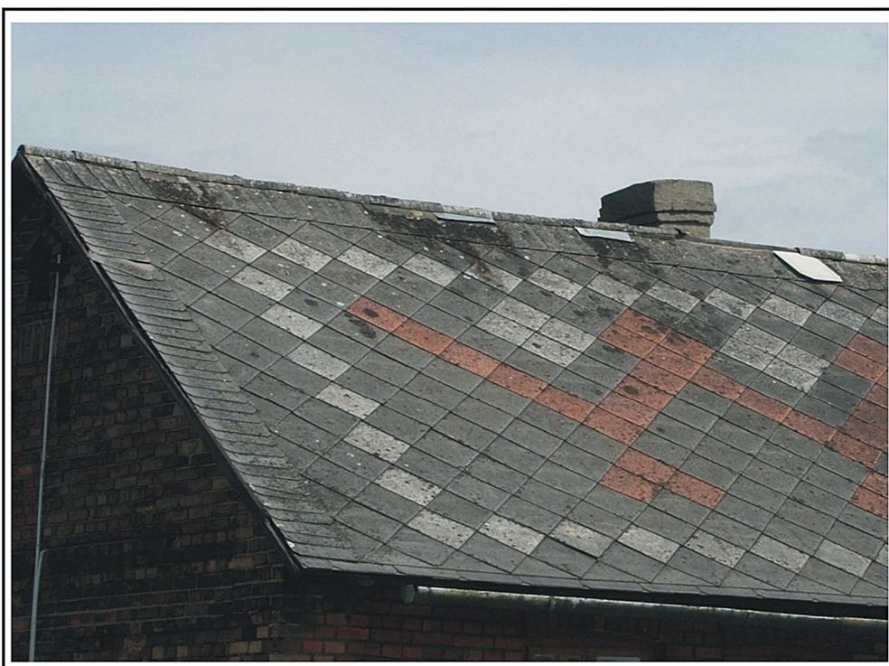
Fot.2 Pokrycie dachowe budynku mieszkalnego z płytek typu "caro" - II stopień pilności
