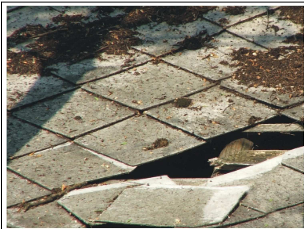
Fot.1 Pokrycie dachowe budynku gospodarczego z płyt typu "caro" - I stopień pilności
